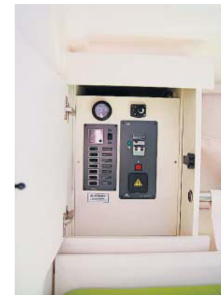
So simpel ist das: Schalttafel
